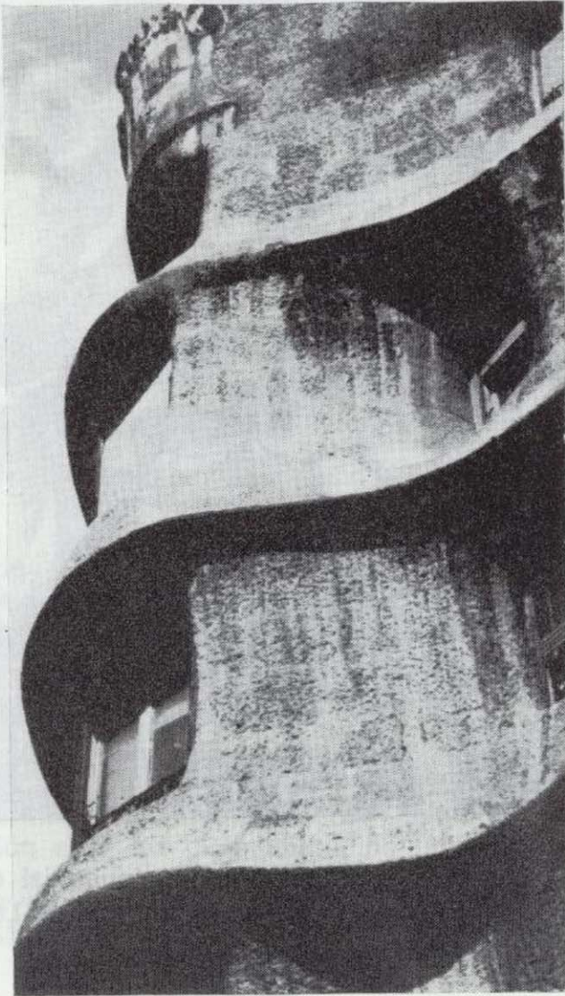
Figura 3.—Costras negras y pátina de ennegrecimiento sobre la piedra de la fachada de La Pedrera (caliza de Vilafranca).
