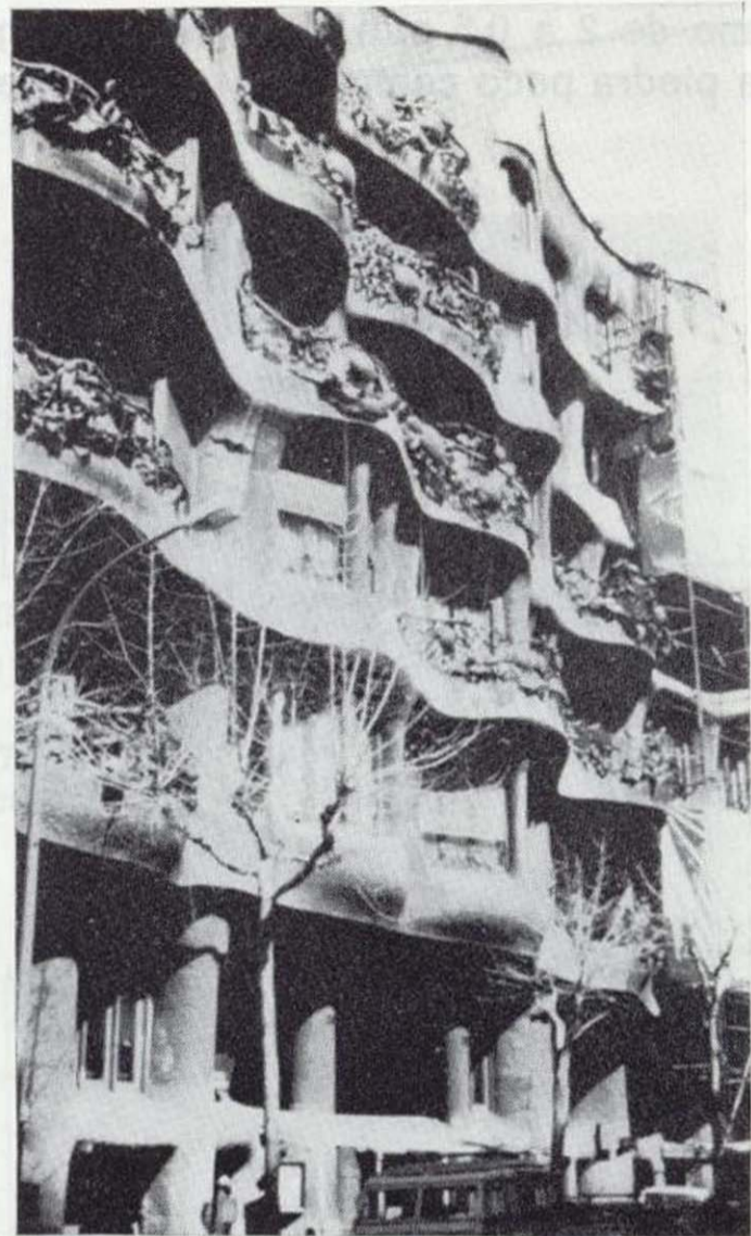
Figura 2.—Detalle de la disposición sinusoidal de los sillares de piedra de Vilafranca de la fachada de La Pedrera.
